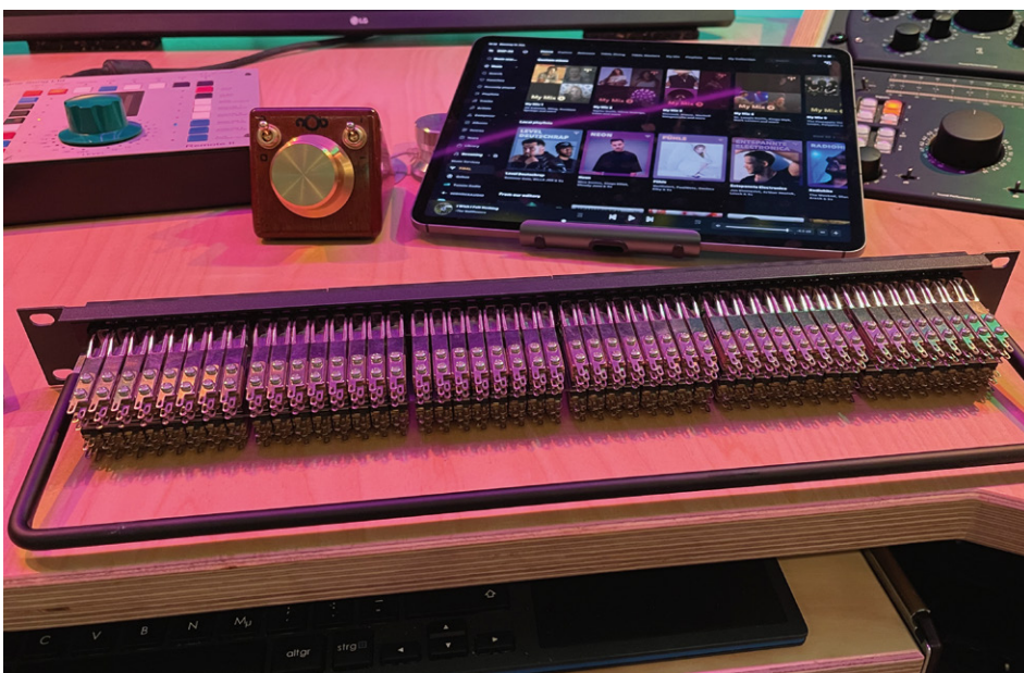
Bild 4: Die Lötaschen des Sommer cable TT-Phone Steckfeldes sind der traditionelle und sehr verbindungs-sichere Ansatz bei Anschluss und Normalisierung. Es gibt aber zum Beispiel auch TT-Steckfelder mit Sub-D-Verbindern auf der Anschlussseite, die eine Installation mit vorkonfektionierten Multicores ermöglichen. Die Normalisierung erfolgt dann über Jumper
